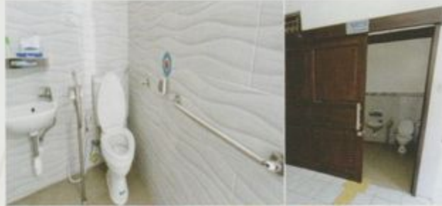
Gambar: Toilet disabilitas pada Pengadilan Negeri Singaraja
